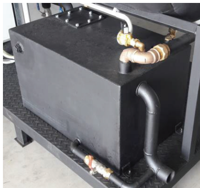
vychlazovací nádrž s dochlazením
