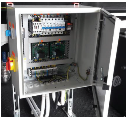
řídící elektro skříň
