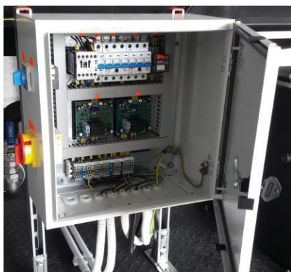
řídící elektro skříň
